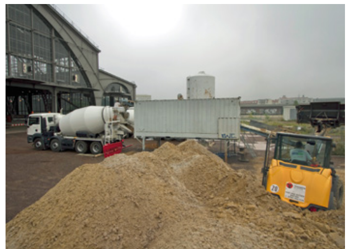
BILD 3: Mischanlage außerhalb der Bahnhofshalle
