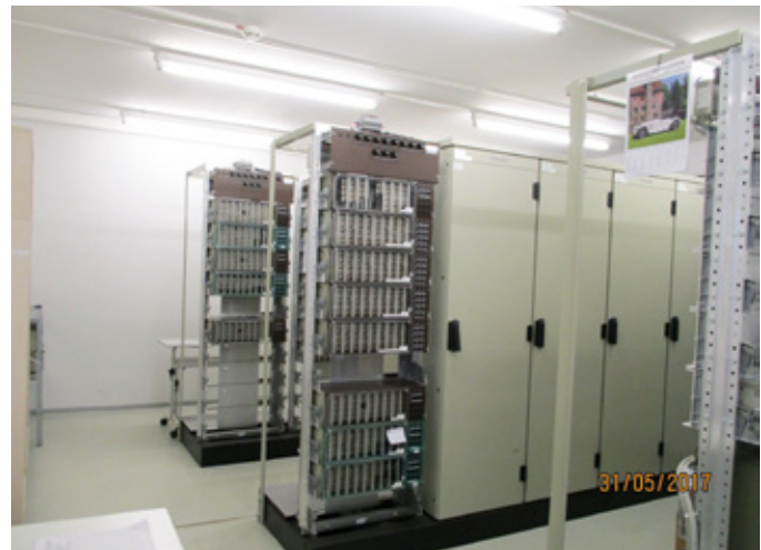
BILD 6: Temporäres Stellwerk für Hp5
