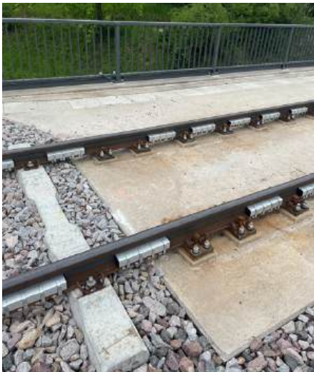
Abb. 3: Eingebaute SSD im Übergangsbereich Strecke zur Brücke bei der Hermann-Hesse-Bahn Quelle: A. Mustafa / infra-tec GmbH
