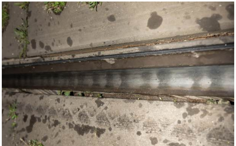
Abb. 1: Beispiel von Schlupfwellen auf Rillenschienen
