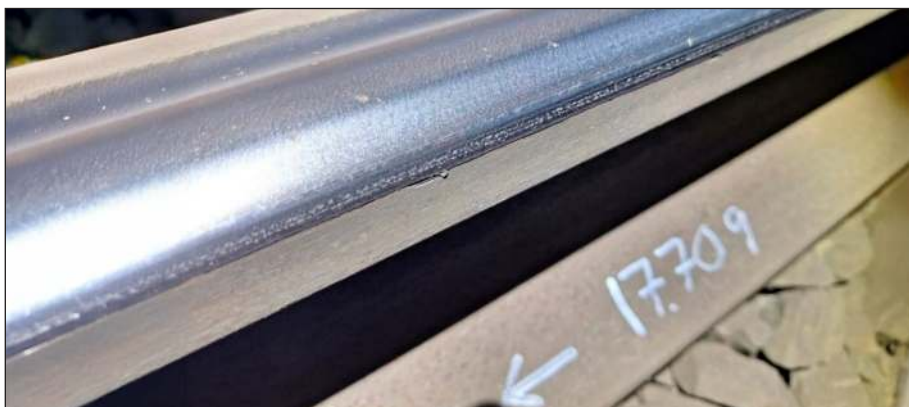
Abb. 7: Zustand vor dem Fräsen – bis zu 3 mm tiefe Risse an der Fahrkante, mit bloßem Auge kaum zu erkennen
