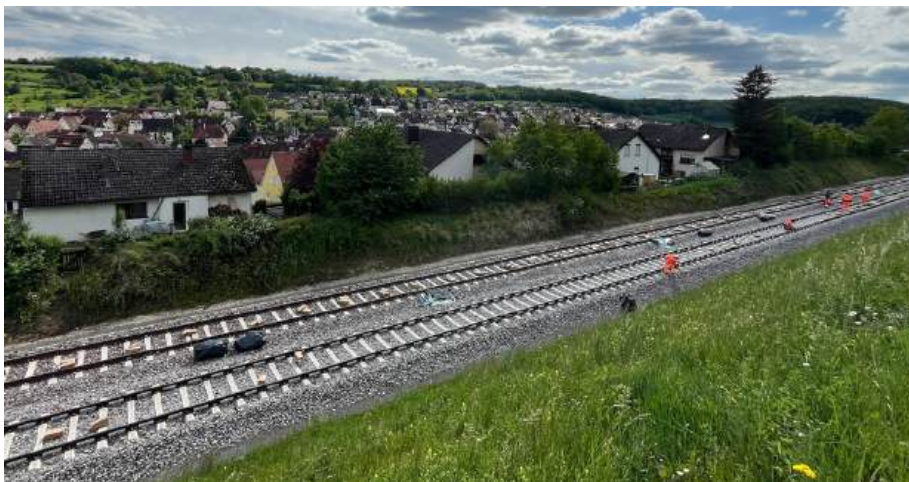
Abb. 5: Durch den Einbau von SSD können Sichtbeziehungen aufrechterhalten bzw. passive Lärmschutzmaßnahmen reduziert werden.
