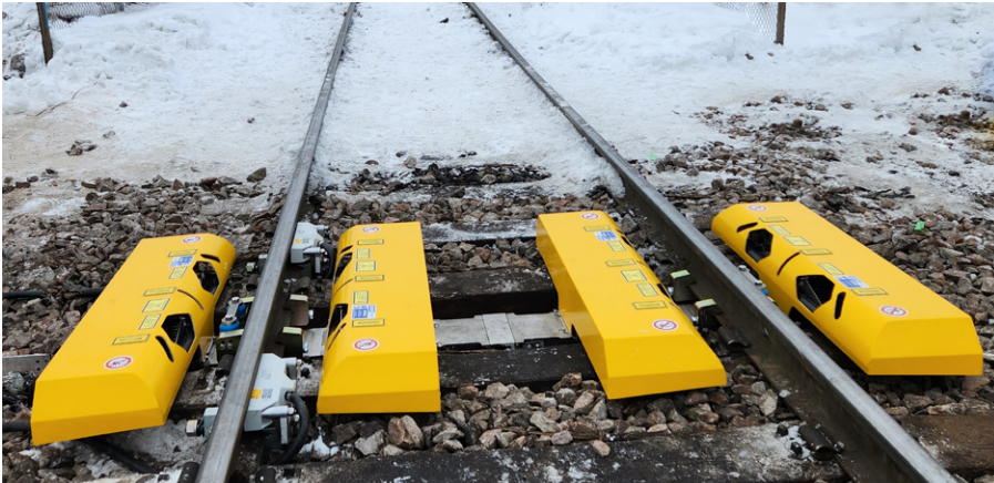
3: WPMS in einem skandinavischen Güterverkehrsknotenpunkt
