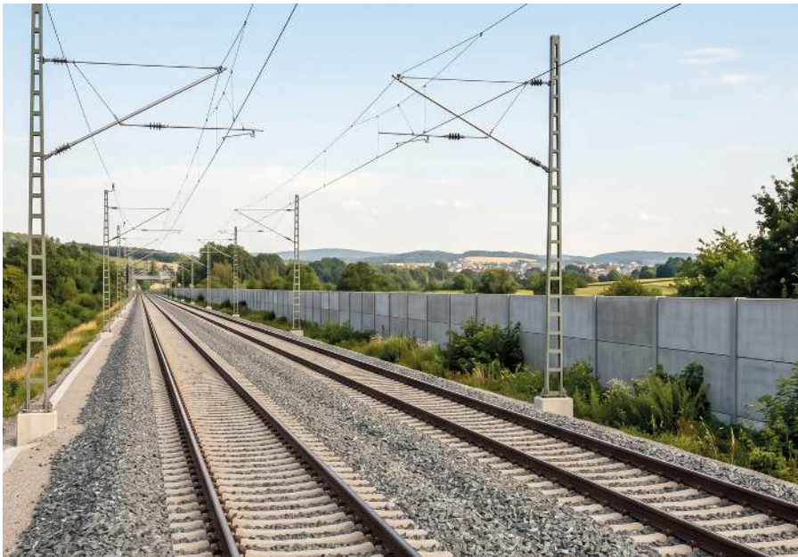
Eine zuverlässige Bahnerdung ist Voraussetzung für den sicheren Betrieb elektrifizierter Bahnstrecken
