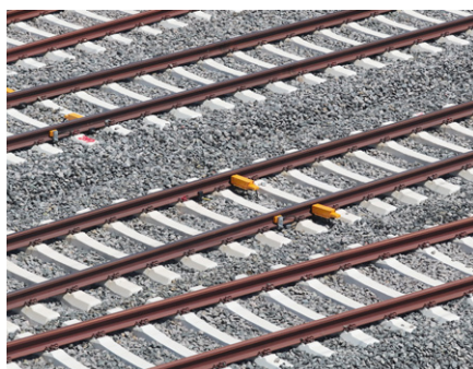
Auf Schienen montierte Detektionsvorrichtungen Quelle: Enekom Enerji Bilişim ve Mühendislik San. Tic. A.Ş.
