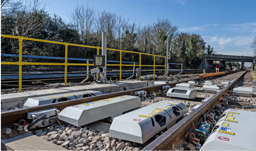
2: Am Gleis installierte VEMS-Module in Großbritannien
