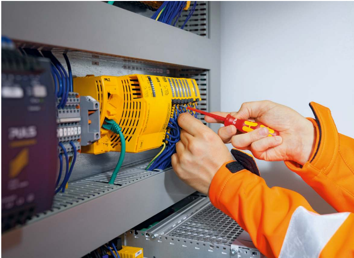
Bild 3: Je nach Anwendung können die vorkonfigurierten Geräte direkt und ohne weitere Konfiguration eingesetzt werden. Dies ermöglicht eine Modernisierung ohne langwierige Gleissperrungen, da die Umstellung auf die SPS-basierte Lösung über Nacht erfolgen kann.
