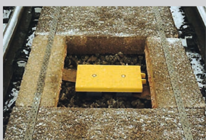
Bild 40: Montage Balise S 21 auf der Y-Schwelle
