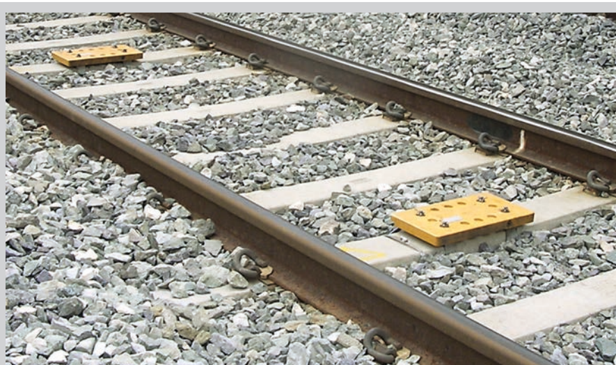
Bild 7: Montage Balise der Firma Bombardier mit Befestigungsklammer um Betonschwelle
