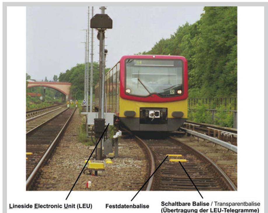
Bild 25: Anordnung einer ZBS-Streckeneinrichtung am Signal
