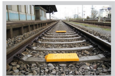
Bild 28: Ankündigungsdatenpunkt für die Transition STM PZB (DB) zu STM KVB (SNCF) im Bahnhof Kehl
