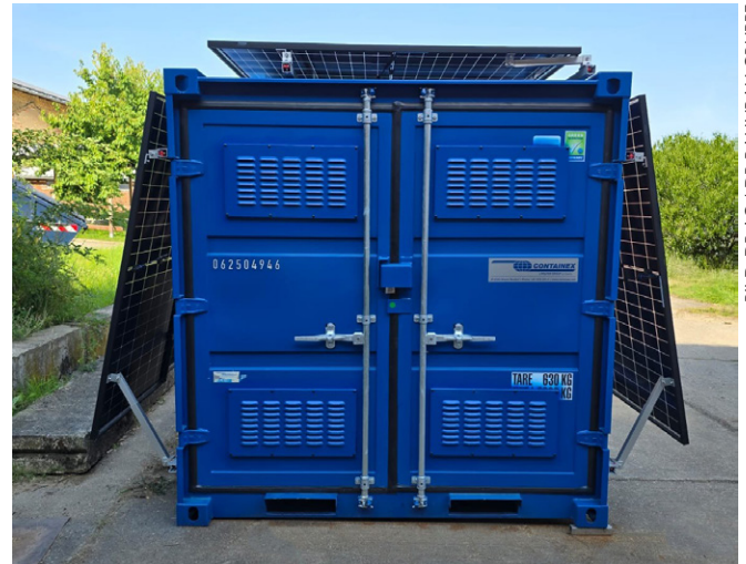
Der EnerRail-M8-Container der DB Bahnbaugruppe kombiniert Methanol-Brennstoffzelle, Photovoltaik und Batteriespeicher in einem 8-Fuß-Container und bietet temporäre und autarke Energieversorgung mit bis zu 8kW
