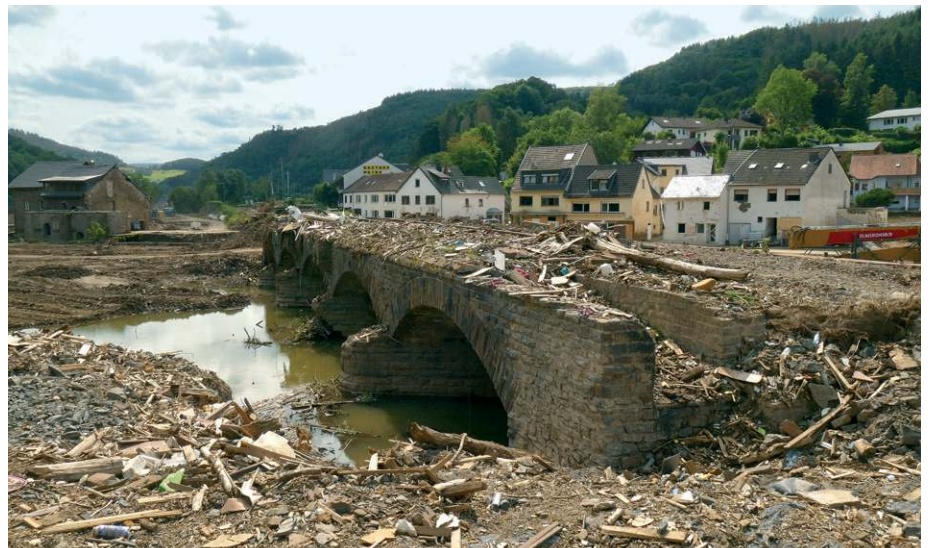
Abb. 1: Zerstörte Brücke im Ahrtal nach dem Starkregen- und Hochwasserereignis im Juli 2021
