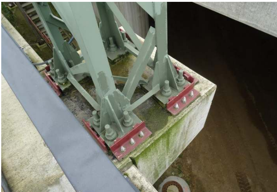
Abb. 6: Seitlich angebrachte Stahlwinkel zum Abtrag der Horizontalkräfte
